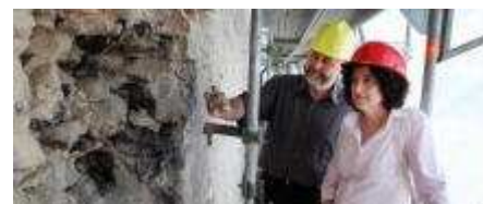
Pfarrerin Dr. Bettina Opitz-Chen begutachtet zusammen mit dem Architekten Alfred Holetzke die Schäden an den Außenwänden, die aus unterschiedlichen Materialien bestehen. Foto: Sascha Kopp
