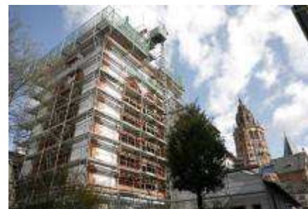
Hinter einem Gerüst ist St. Johannis verschwunden. Die Außenrenovierung hat begonnen. Foto: Sascha Kopp
