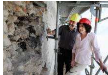
Pfarrerin Dr. Bettina Opitz-Chen begutachtet zusammen mit dem Architekten Alfred Holetzke die Schäden an den Außenwänden, die aus unterschiedlichen Materialien bestehen. Sascha Kopp
