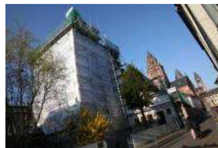
Die Johanniskirche ist durch ein riesiges Stahlgerüst eingehüllt, ein 90 Meter langer Bauzaun umgibt das Areal. Die Gemeinde will aus der Not eine Tugend machen und will den Zaun zur künstlerischen Gestaltung freigeben. Foto: Sascha Kopp
